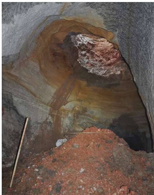
Propad do dobývky bývalého kaolinového dolu v lokalitě Orty u Hosína, okres České Budějovice. Řešeno v rámci Registru starých důlních děl.
