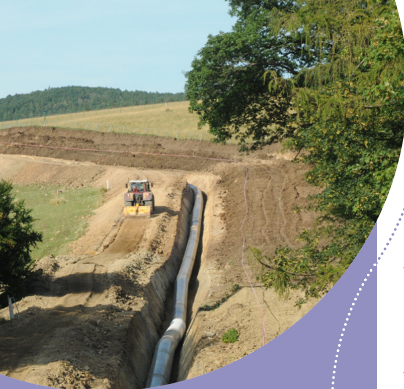
► Svahová deformace 24-44-18/3 s trasou plynovodu Moravia v Jestřebicích. Foto O. Krejčí.
