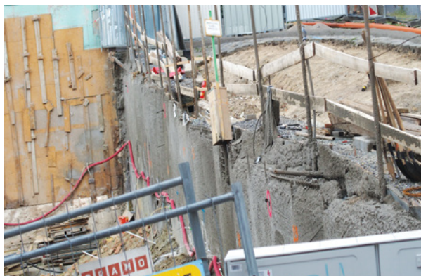
▲ Oživení starého sesuvu při hloubení stavební jámy při křížení ulic Leitnerova a Kopečná v zastavěné části středu města Brna. Foto O. Krejčí.
