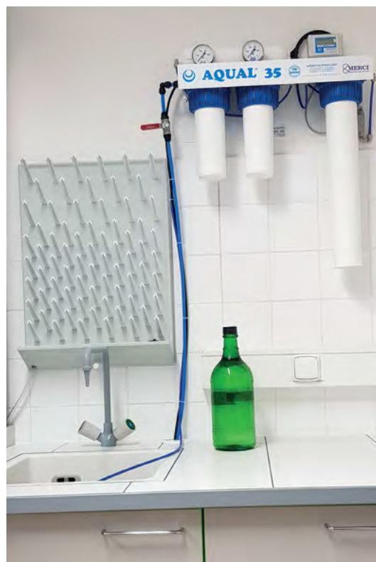
➤ Zařízení pro přípravu demineralizované vody. Foto T. Pecka.
