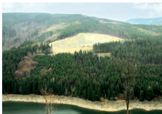
⚡ Odtěžování sesuvu Řečice, ohrožujícího vodní nádrž Šance na Ostravici. Foto O. Krejčí.
