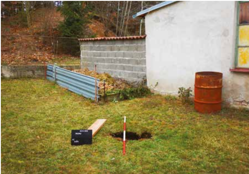
Propad staré šachty dolu Kuntery na zahradě rodinného domku v Kaňku, okres Kutná Hora (12/2016).
