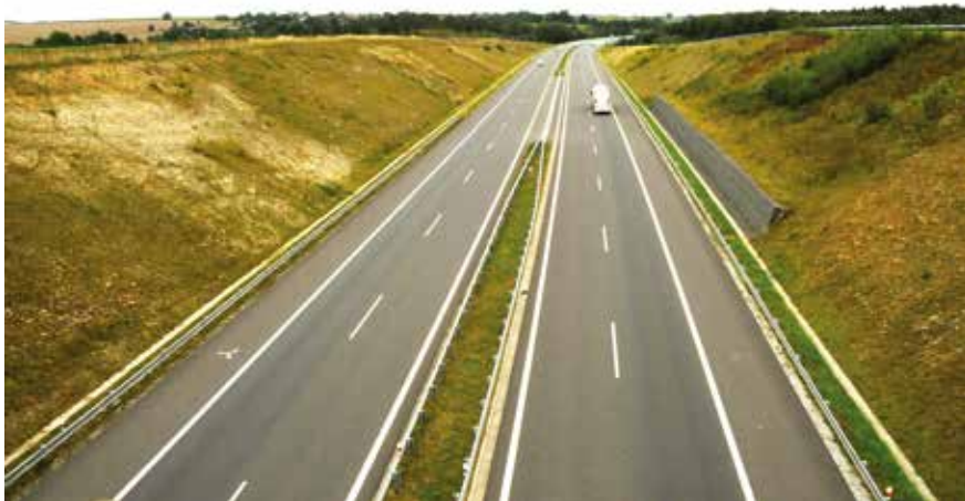
Dálnice D3 Tábor – Veselí nad Lužnicí. Na snímku je vidět stabilizovaná pravá část zářezu, kde probíhá dříve nezjištěné koryto terciálních sedimentů, které se stalo příčinou sesouvání. Levá strana je dosud nezajištěná.
