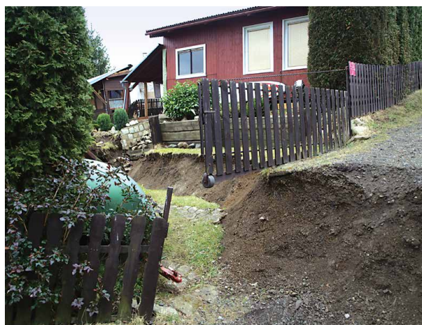
■ Sesuvná trhlina pod rekreačním objektem.
