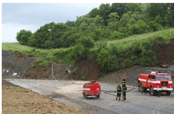
● Červnový sesuv přehradil již téměř hotovou dálnici z Prahy do Drážďan, a to včetně odvodňovacích prvků a kanalizace. Vzniklé hrazené jezero bylo hasiči postupně přečerpáváno přes akumulaci sesuvu dále do údolí V Ječkách.
