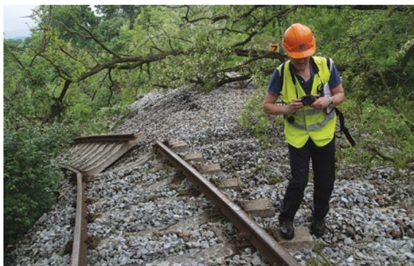
● Sesuvem poničená regionální železniční trať č. 097 Lovosice–Teplice v úseku mezi železničními stanicemi Dobkovičky a Radejčín.
