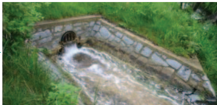
Výpust vody z ČDV Příbram II do potoka Kocába.
