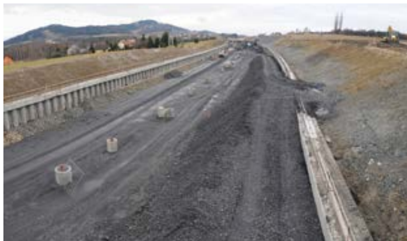
Pohled na trasu R 48 z lávky u Lysůvek směrem k Frýdku-Místku. Podél pravé stěny zářezu se nachází sesuvné území (foto O. Krejčí).
