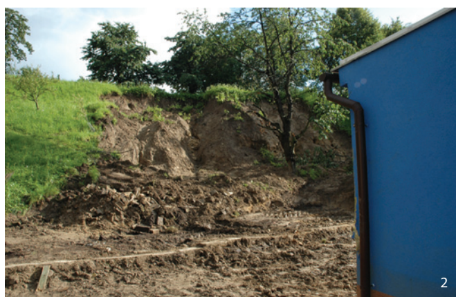
1/ Propad nad železničním tunelem v Mostech u Jablunkova (foto O. Krejčí, listopad 2009).
